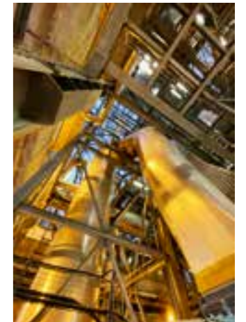
Cheminée de rejet atmosphérique du CMVD.
