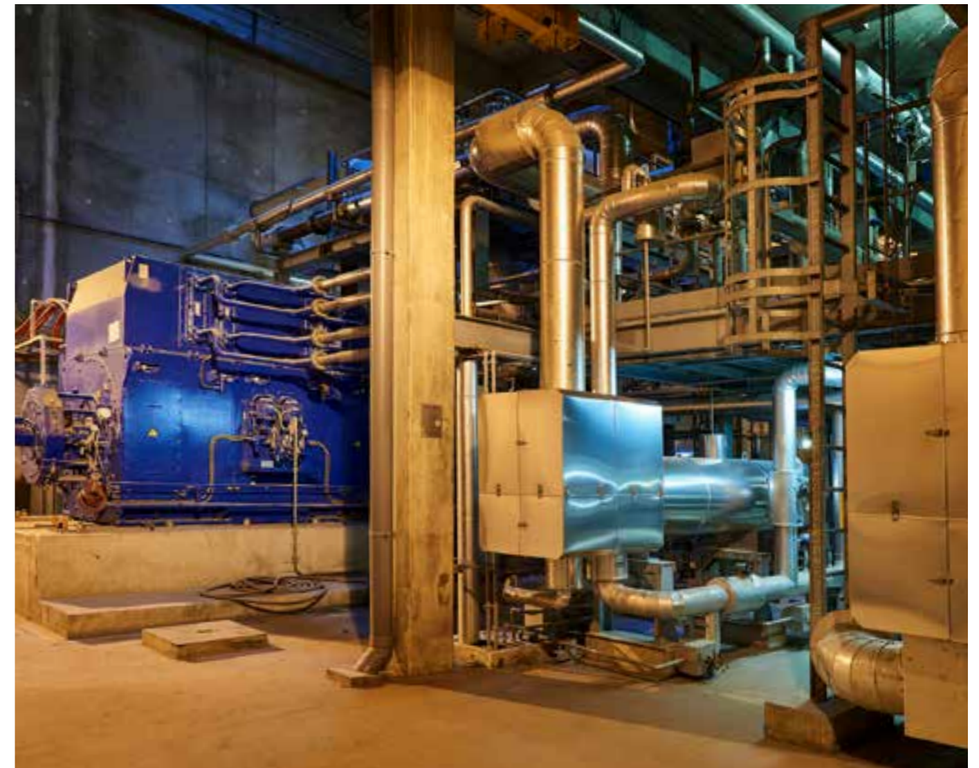
Salle de transformation de la vapeur en électricité ; en bleu: la turbine.
